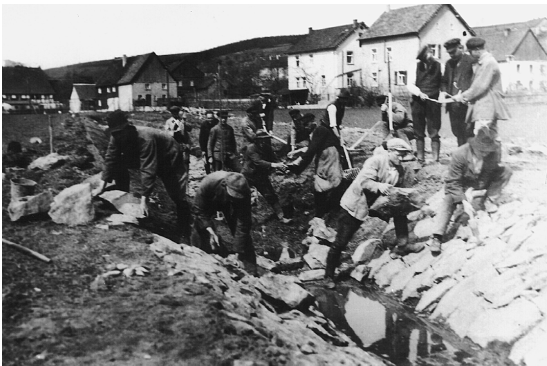
Die Ufer des Heggener Baches werden befestigt – eine Maßnahme im Rahmen der Erwerbslosenfürsorge Anfang der 30er Jahre. Heute fließt der Bach nur noch streckenweise in einem offenen Bett, der Rest ist verrohrt.
